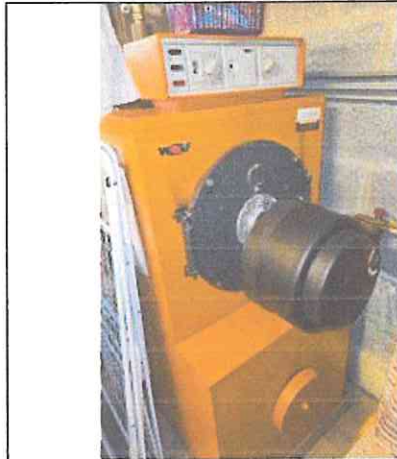
Chaudière Mazout (Chauffage et eau chaude sanitaire)
