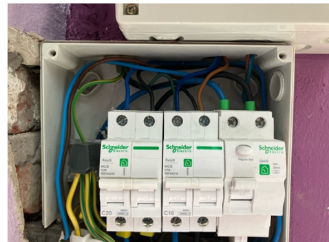
( Elektrisch bord - binnenkant )
