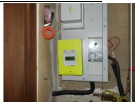
Photo du Compteur électrique
