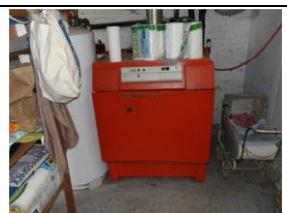
Photo n° PhGaz006 Localisation : Garage Chaudière VIESSMANN (Type : Raccordé) Localisation sur croquis : 002
