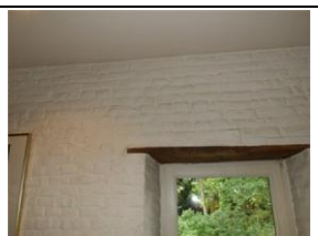
Photo n° PhGaz005 20.1 : le local équipé ou prévu pour un appareil d'utilisation n'est pas pourvu de sortie d'air.
