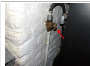
Photo n° PhGaz002 8a3 : au moins un organe de coupure d'appareil n'est pas manœuvrable.
