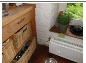
Photo n° PhGaz004 19.a1 : le local équipé ou prévu pour un appareil de cuisson seul n'est pas pourvu d'une amenée d'air ou celle-ci est située à plus de 2 pièces d'intervalle.
