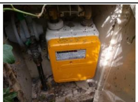
Photo n° du Compteur Gaz
