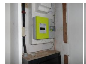
Photo du Compteur électrique
