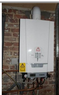
Photo n° PhGaz001 Localisation : Débarras Chaudière DE DIETRICH (Type : Etanche) Localisation sur croquis : 001
