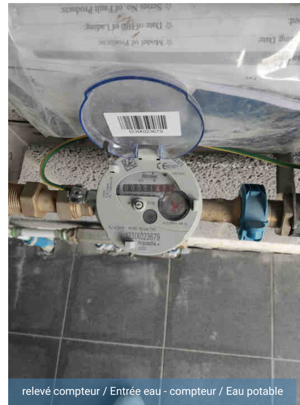
emplacement compteur eau / Entrée eau - compteur / Eau potable
