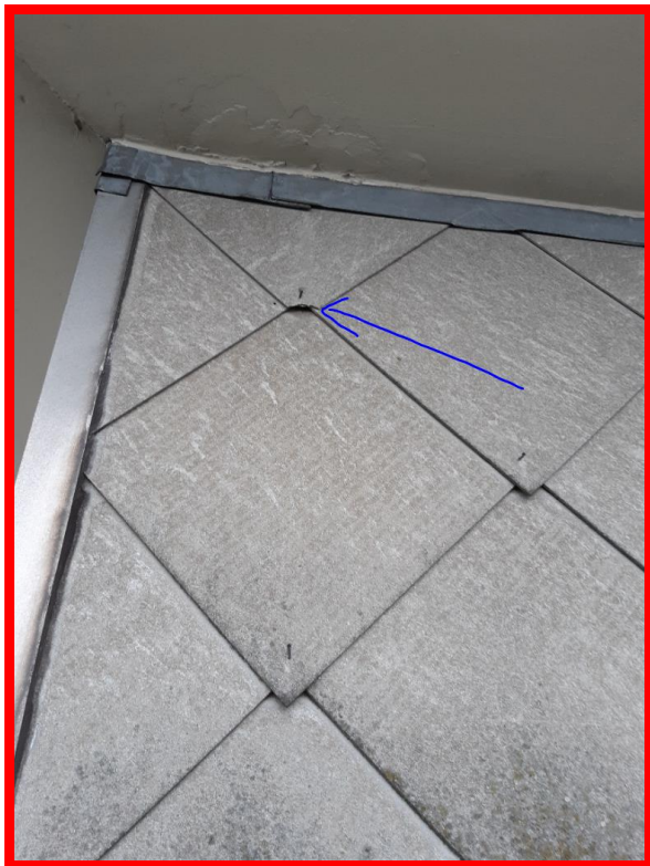
Figuur 12: Leien aan de gevel op het dak: asbest aanwezig.
