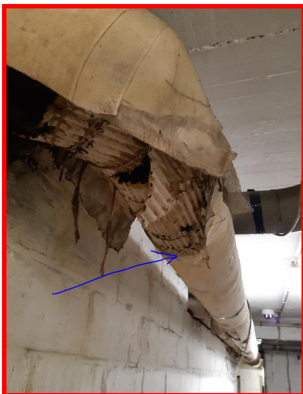
Figuur 9: Buisisolatie in de keldergangen: asbest aanwezig
