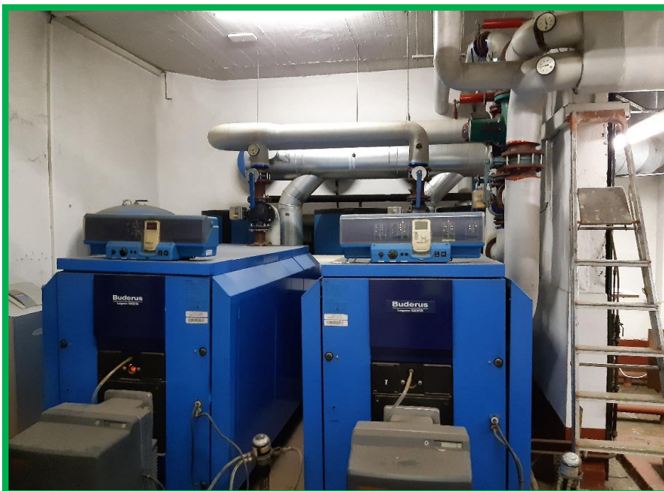
Figuur 5: Vernieuwde branders (2002): geen asbest.
