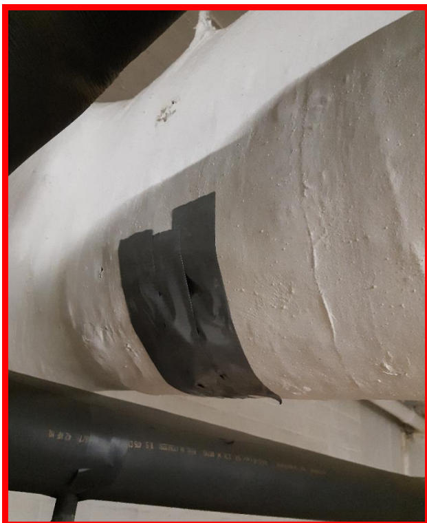
Figuur 7: Buisisolatie in de stookruimte in de kelder: asbest aanwezig
