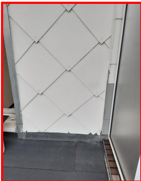
Figuur 11: Leien aan de gevel op het dak: Asbest aanwezig.
