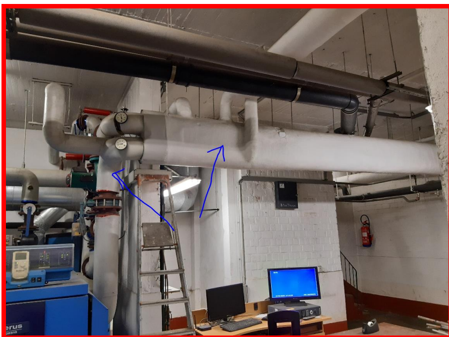
Figuur 6: Buisisolatie in de stookruimte in de kelder:
