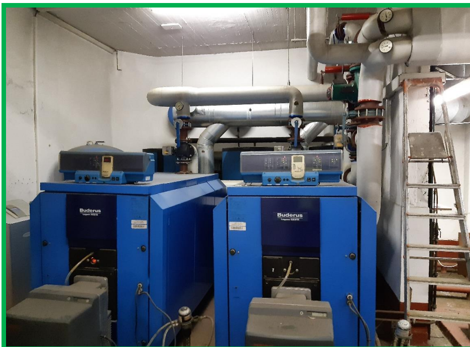
Figuur 5: Vernieuwde branders (2002): geen asbest.
