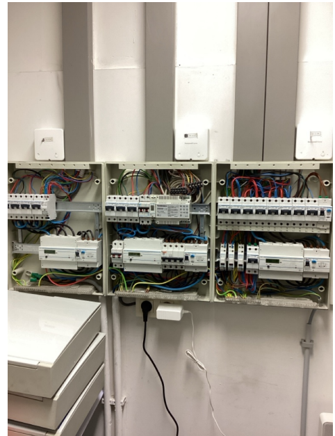
(Elektrisch bord - binnenkant)
