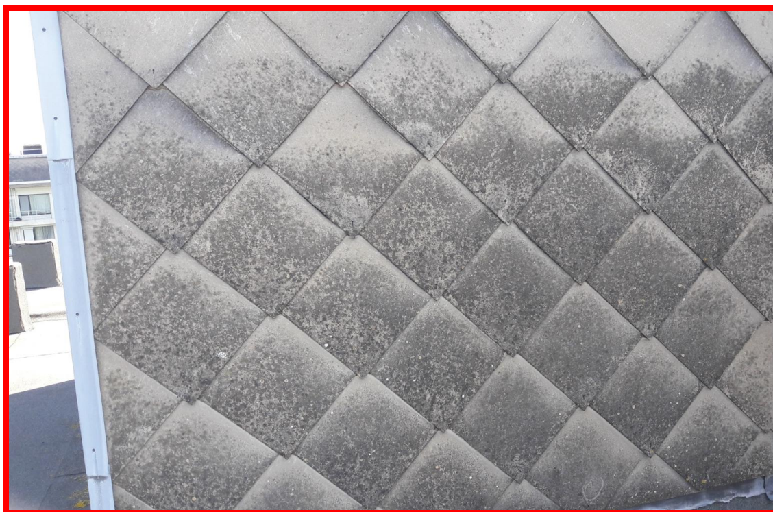
Figuur 10: Leien op dak tegen muur: asbest aanwezig.
