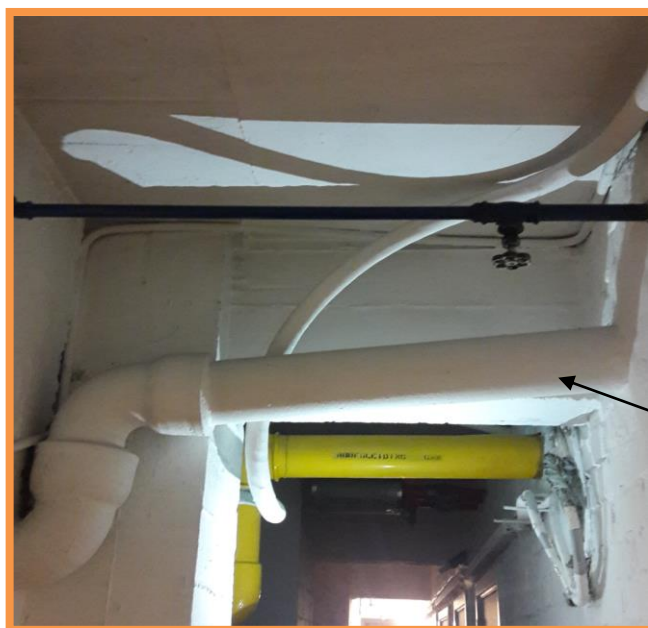
Figuur 6: Cementbuis in de kelder: mogelijk asbest aanwezig.
