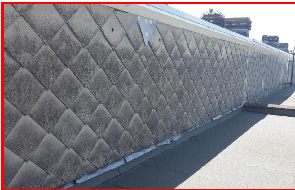
Figuur 9: Leien op dak tegen muur: asbest aanwezig.
