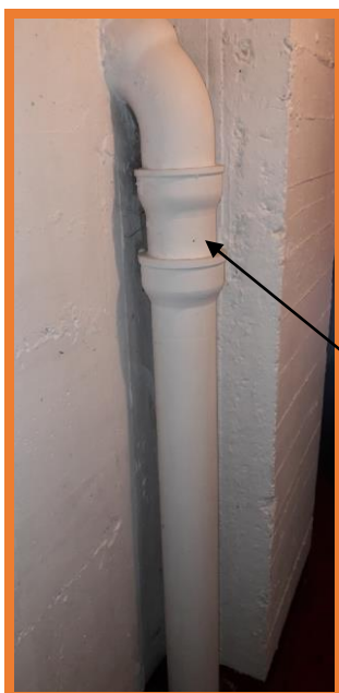
Figuur 7: Cementbuis in de kelder: mogelijk asbest aanwezig.
