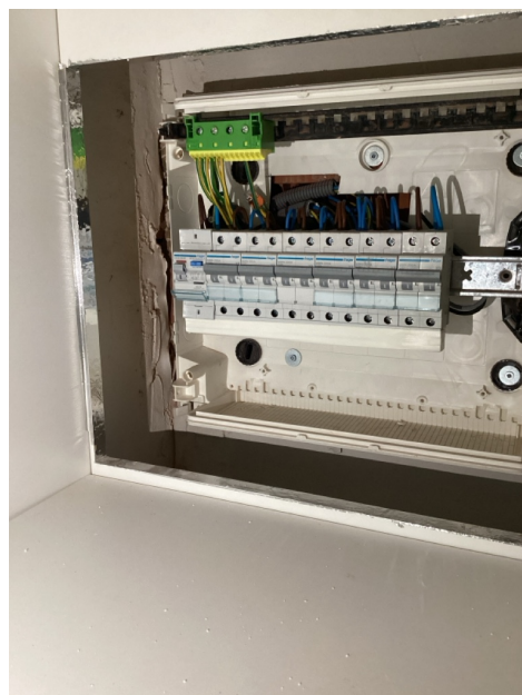
( Elektrisch bord - binnenkant )
