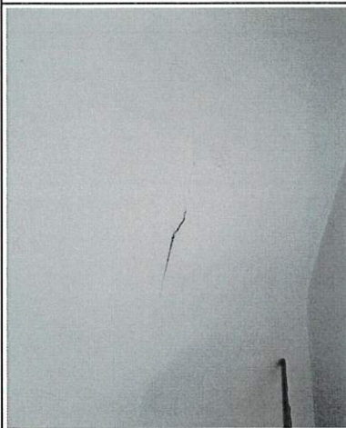
Foto 34: 113: beschadiging (excl. vochtschade) of verwerking / noodzakelijke afwerking ontbreekt
