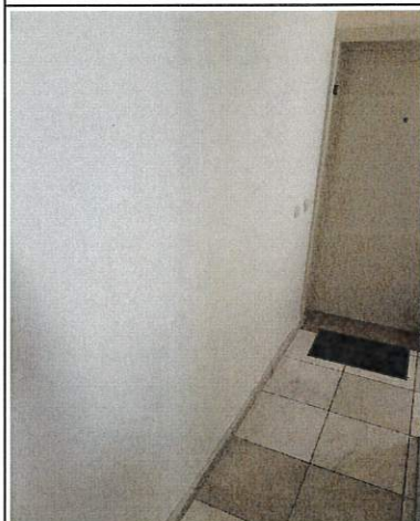
Foto 18: Hersteld gebrek: vochtschade
