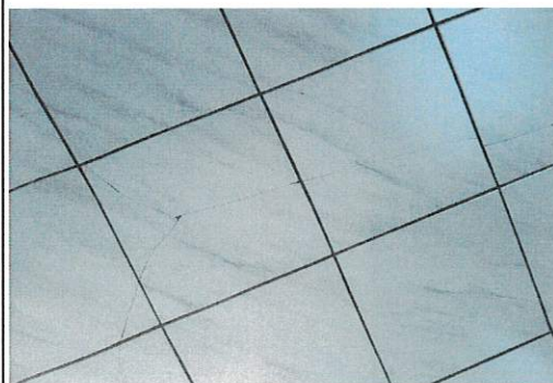
Foto 36: 162: beschadiging (excl. vochtschade) of verwerking / noodzakelijke afwerking ontbreekt
