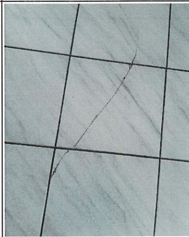
Foto 35: 132: beschadiging (excl. vochtschade) of verwerking / noodzakelijke afwerking ontbreekt
