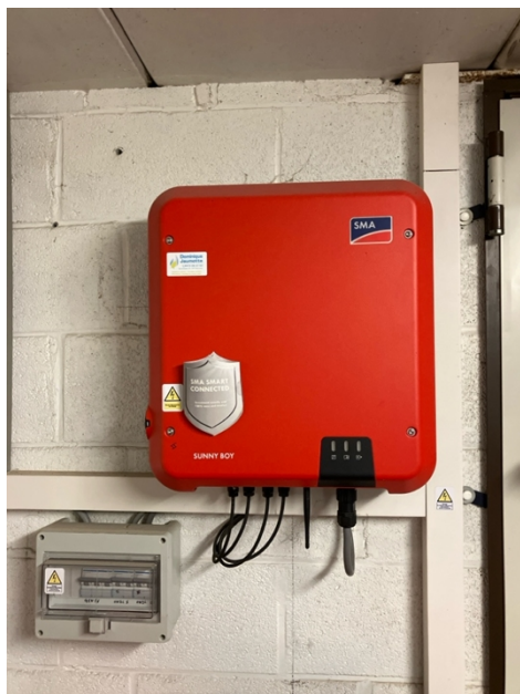
( Photo onduleur DC-AC (distinct) )
