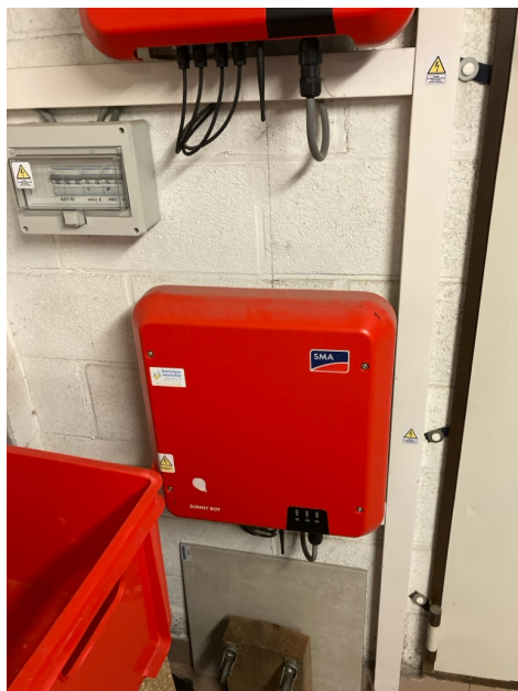
( Photo onduleur DC-AC (distinct) )
