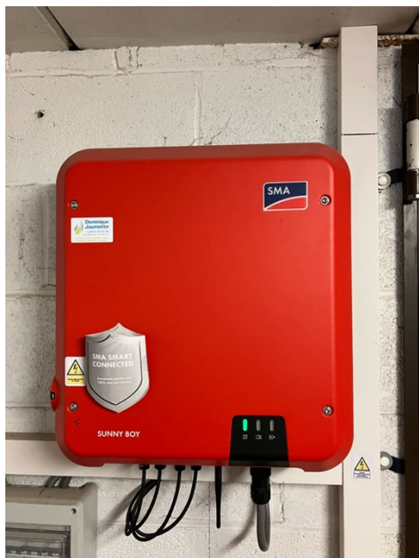
( Photo onduleur DC-AC (distinct) )
