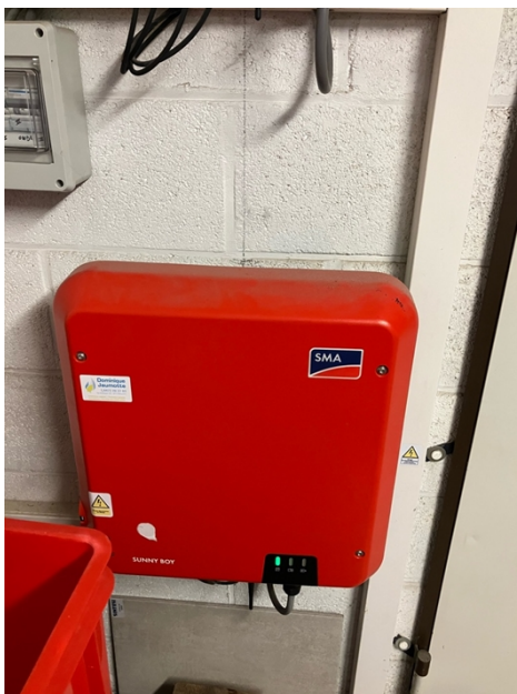
( Photo onduleur DC-AC (distinct) )
