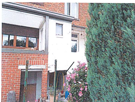
Mur humide sous les toilettes.
