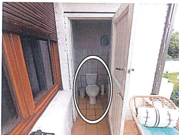
Mur arrière et sol humide dans les toilettes de la véranda.
