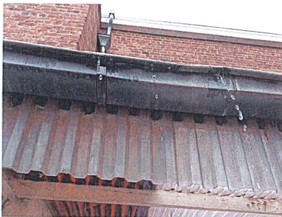
Débordement de la gouttière en zinc.
