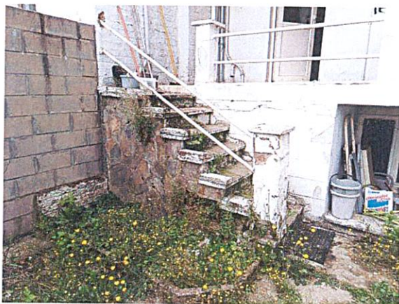
Mauvais état de l'escalier.
