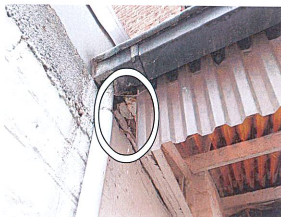
Eau qui déborde la gouttière en zinc.
