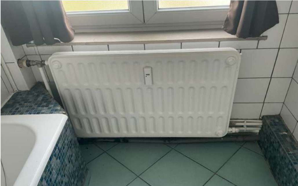
Photo 235 • Salle de bains / Radiateur
