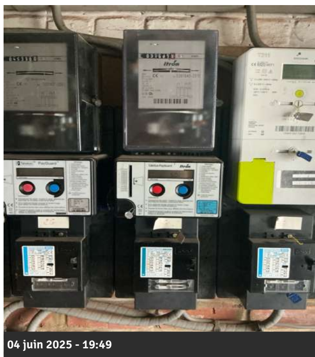
Photo 4 • Compteur / Electricité (HP)
