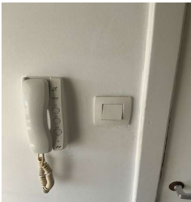
Photo 98 • Hall d'entrée / Interrupteur / prise
