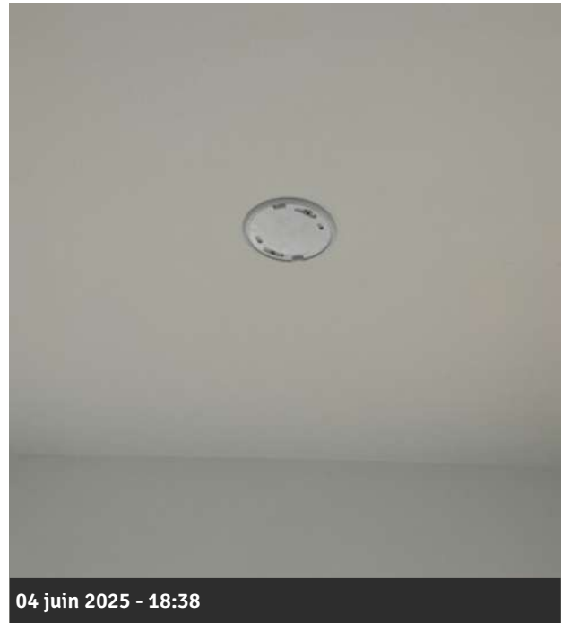
Photo 101 • Hall d'entrée / détecteur de fumée
