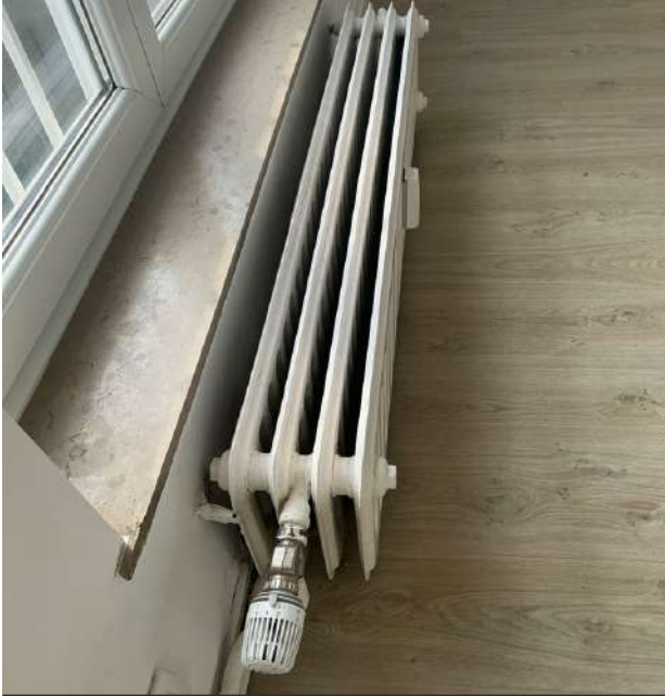
Photo 120 • Salle à manger / séjour / Radiateur
