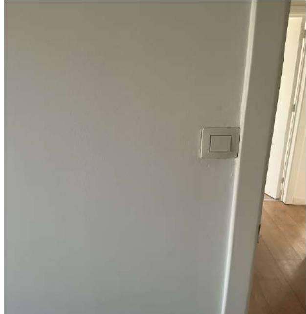
Photo 282 • Chambre / Interrupteur / prise
