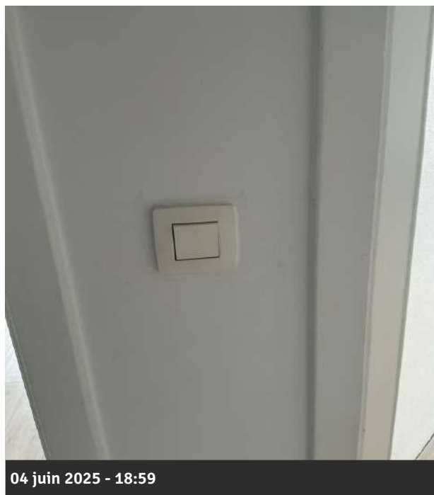
Photo 163 • Hall de nuit / Interrupteur / prise
