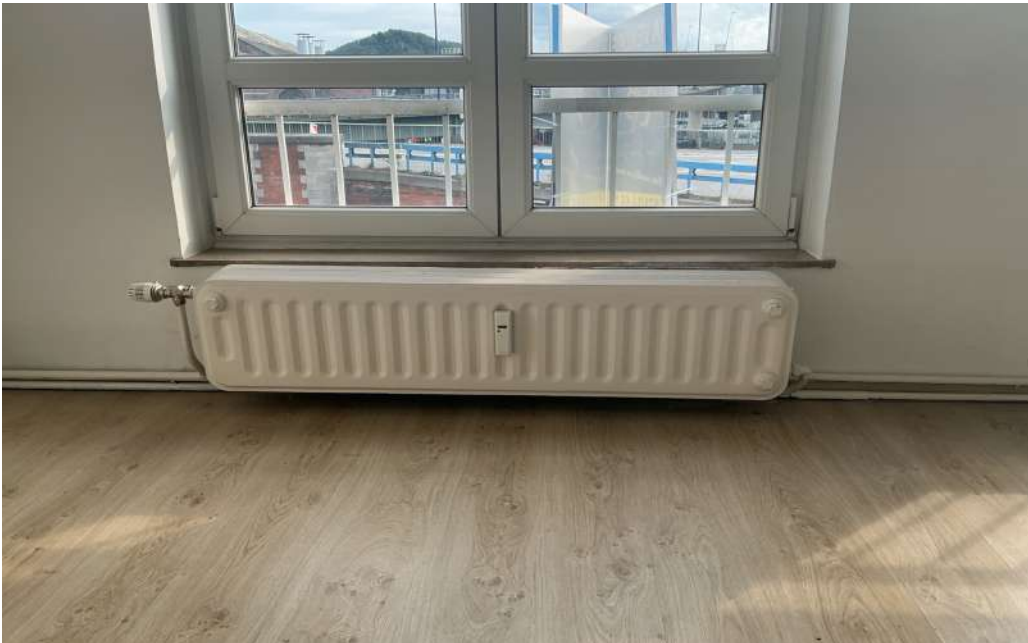
Photo 121 • Salle à manger / séjour / Radiateur
