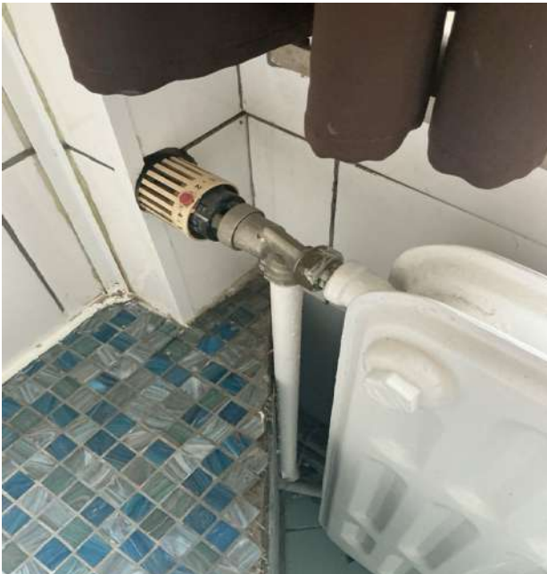
Photo 236 • Salle de bains / Radiateur
