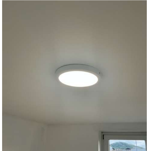
Photo 207 • Chambre / Point lumineux
