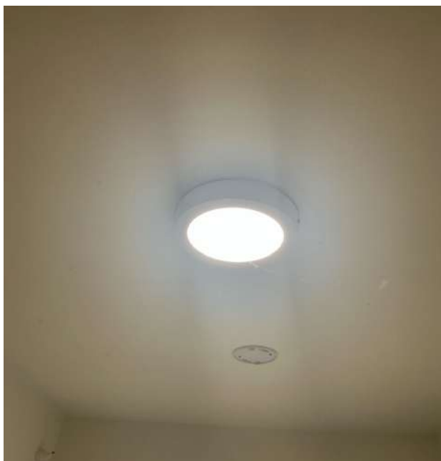
Photo 95 • Hall d'entrée / Point lumineux
