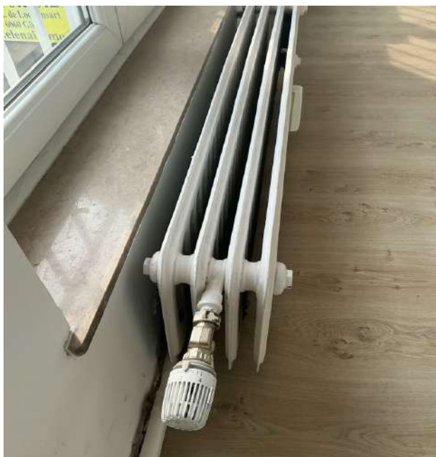
Photo 122 • Salle à manger / séjour / Radiateur
