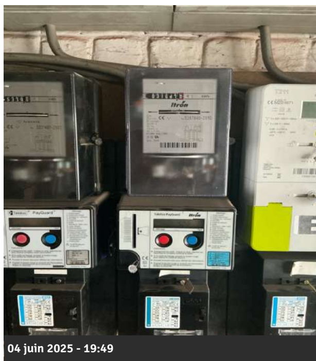
Photo 5 • Compteur / Electricité (HP)
