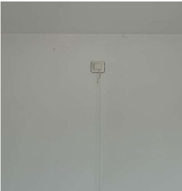
Photo 283 • Chambre / Interrupteur / prise
