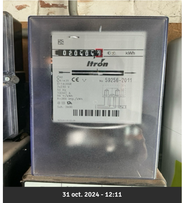
Photo 3 • Compteur / Electricité (HP)
