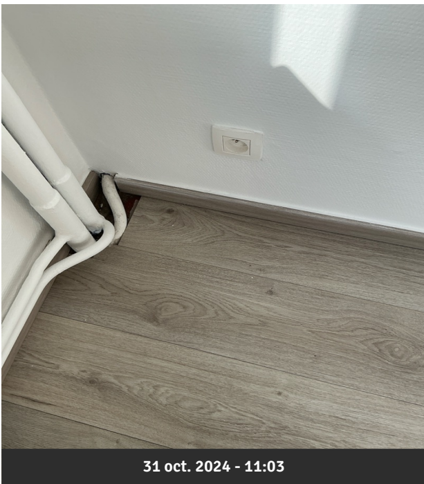
Photo 62 • Chambre en face du pont / Interrupteur / prise
