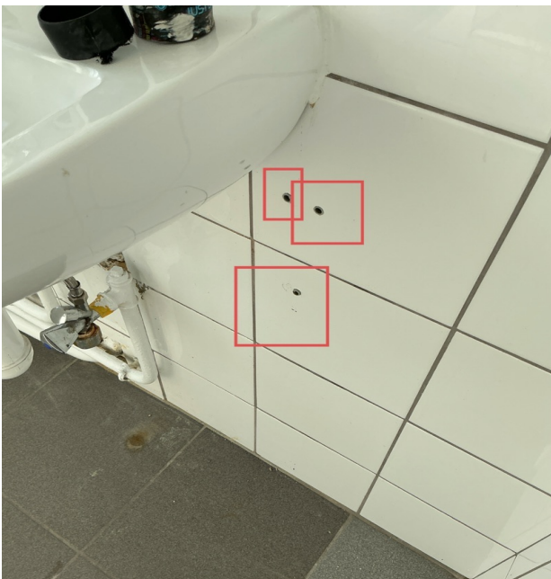
Photo 78 • Salle de bains / Mur / Trou
