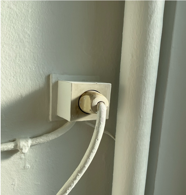
Photo 97 • Salle de bains / Interrupteur / prise
