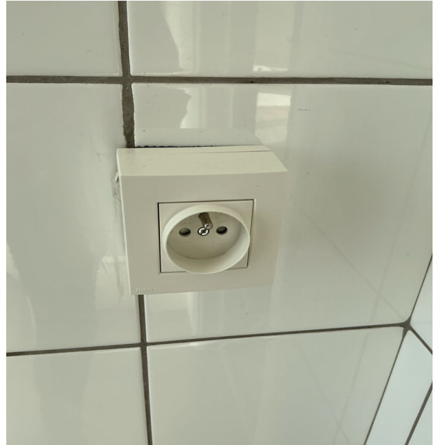
Photo 98 • Salle de bains / Interrupteur / prise
