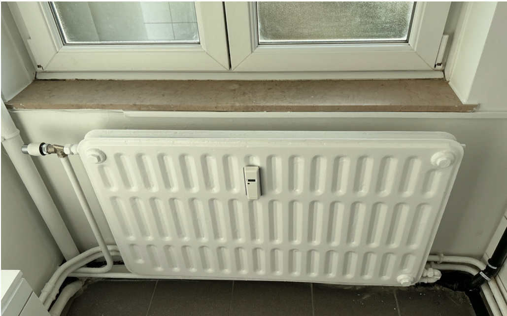
Photo 79 • Salle de bains / Radiateur
