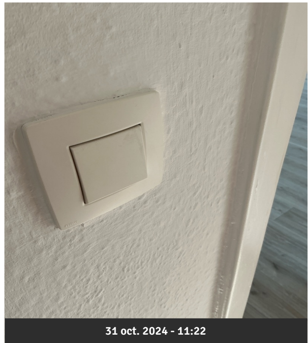
Photo 136 • Couloir / Interrupteur / prise
