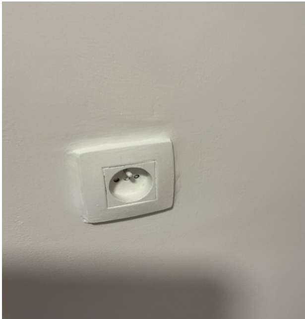
Photo 188 • Cuisine / Interrupteur / prise
