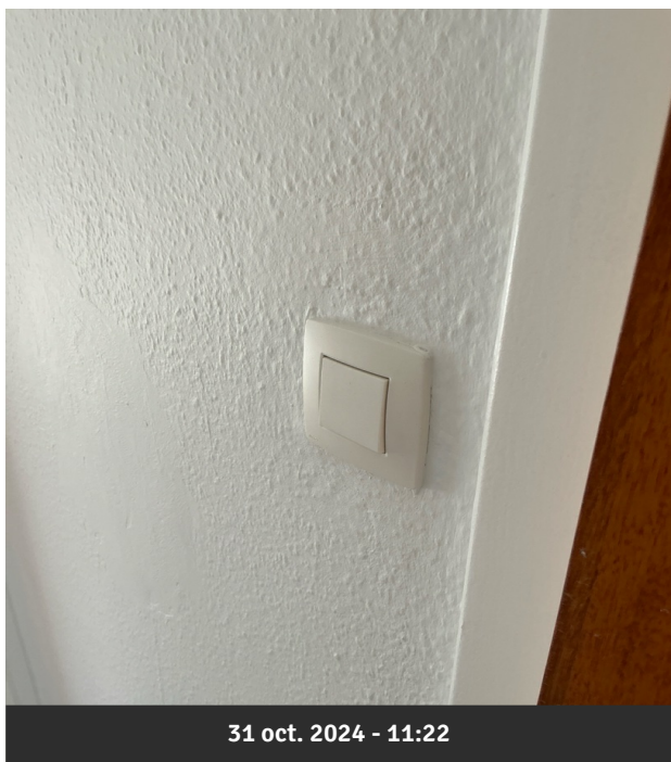
Photo 137 • Couloir / Interrupteur / prise
