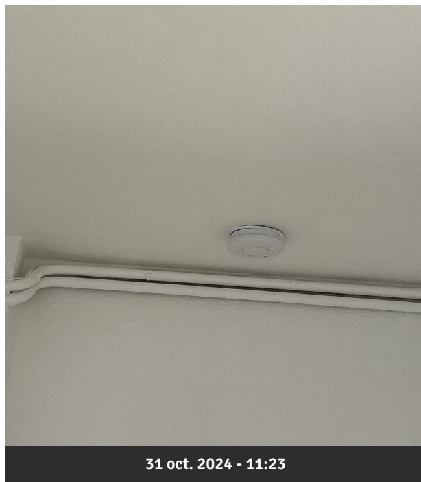
Photo 138 • Couloir / détecteur de fumée
