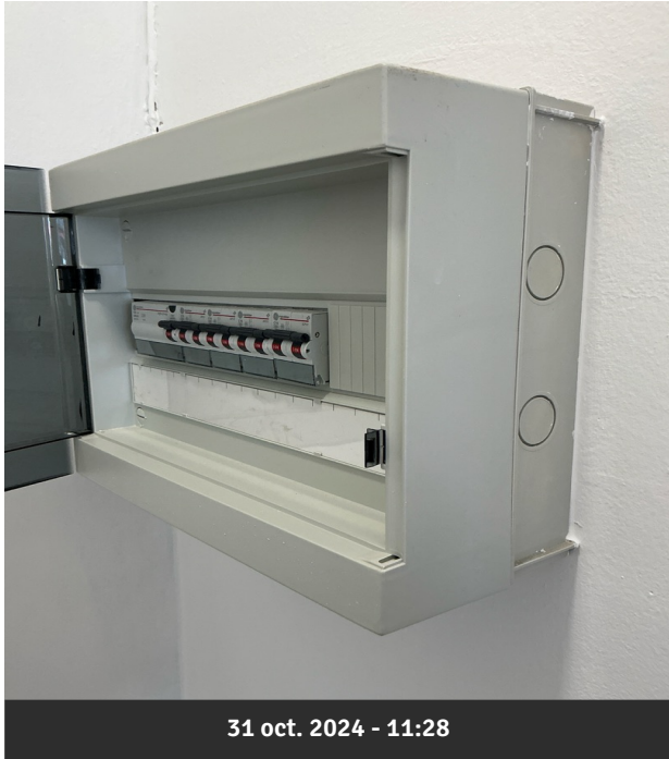
Photo 160 • WC / Tableau électrique général
