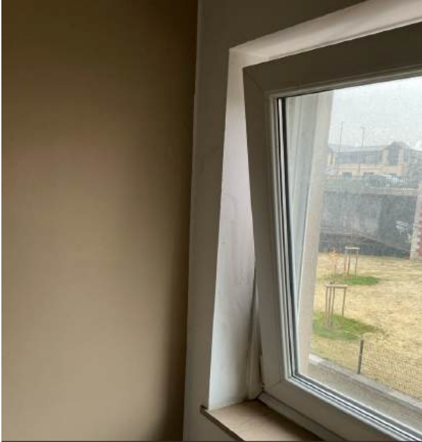
Photo 75 • Salle à manger + salon / Mur / Nettoyage incomplet
