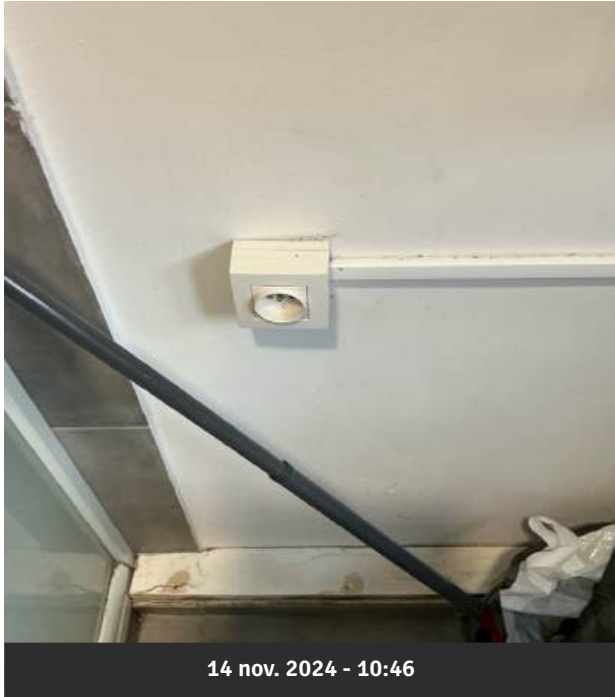
Photo 184 • Salle de bains / Interrupteur / prise
