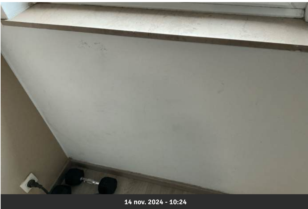
Photo 74 • Salle à manger + salon / Mur / Nettoyage incomplet
