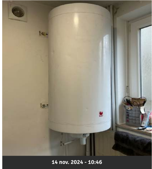
Photo 185 • Salle de bains / Chauffe-eau
