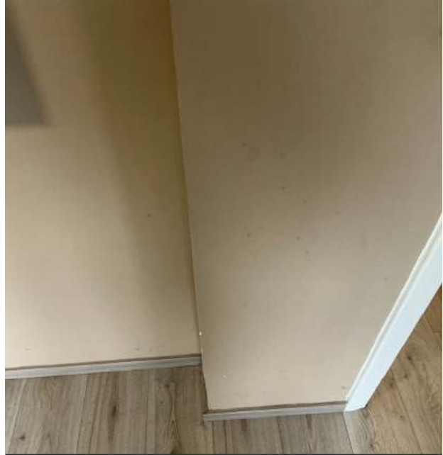
Photo 76 • Salle à manger + salon / Mur / Nettoyage incomplet
