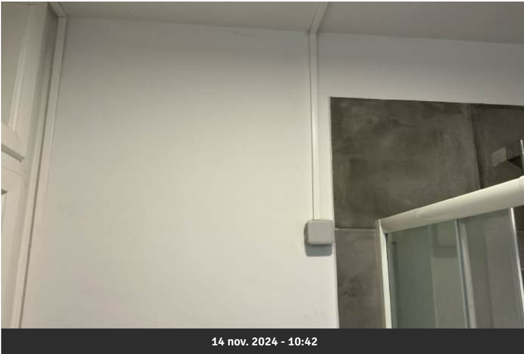
Photo 161 • Salle de bains / Mur / Nettoyage incomplet
