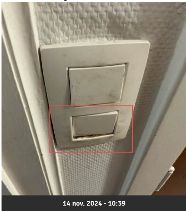
Photo 119 • Hall / Interrupteur / prise / Élément endommagé
