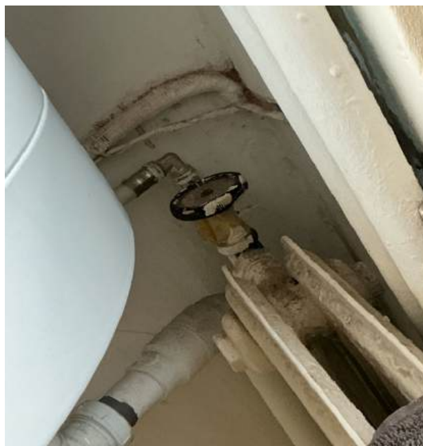
Photo 166 • Salle de bains / Radiateur
