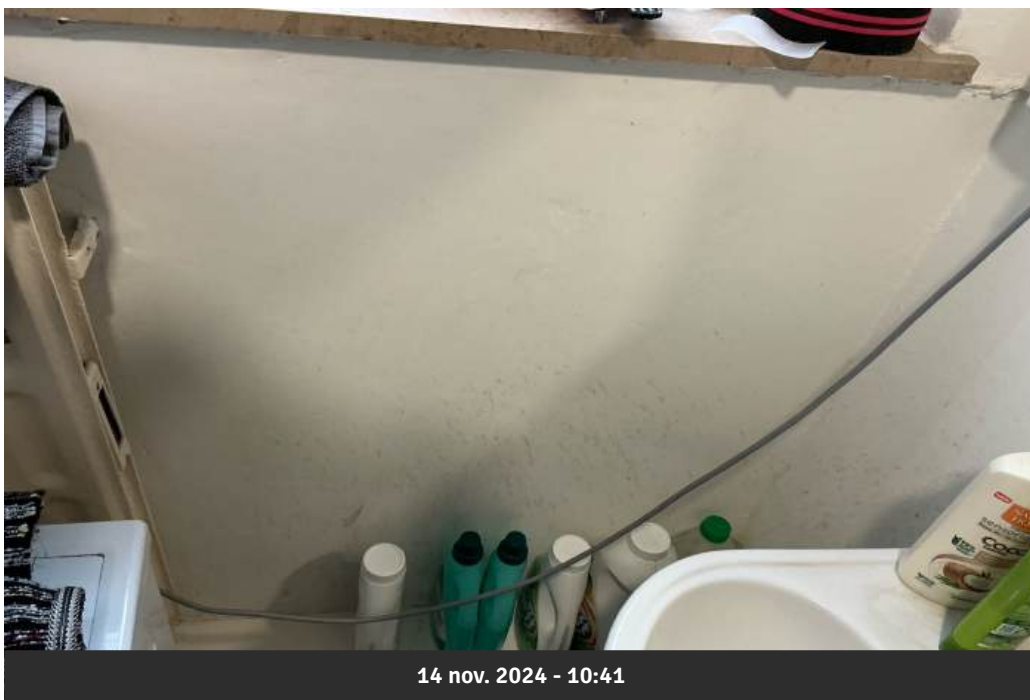
Photo 157 • Salle de bains / Mur / Nettoyage incomplet
