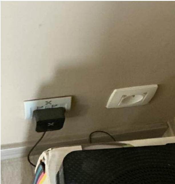
Photo 101 • Salle à manger + salon / Interrupteur / prise
