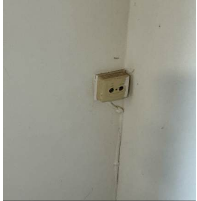
Photo 100 • Salle à manger + salon / Interrupteur / prise
