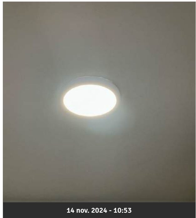
Photo 206 • Chambre / Point lumineux
