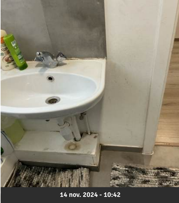
Photo 160 • Salle de bains / Mur / Nettoyage incomplet
