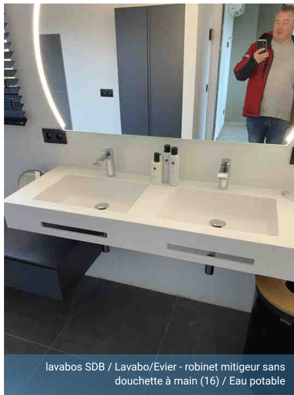
lavabo SDD / Lavabo/Evier - robinet mitigeur sans douchette à main (23) / Eau potable
