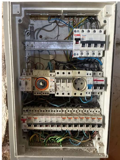
( Tableau électrique - intérieur )
