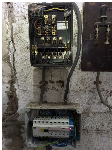
( Tableau électrique - intérieur )
