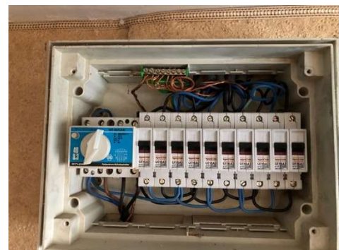
( Tableau électrique - intérieur )
