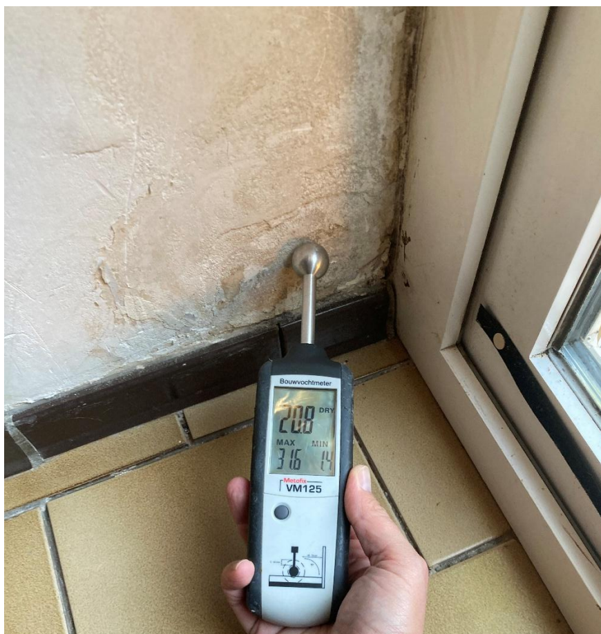
Photo n°11 : rez-de-chaussée, salon sur façade arrière Mesure d'humidité absolue de 20,8 sur une échelle de 100,0
