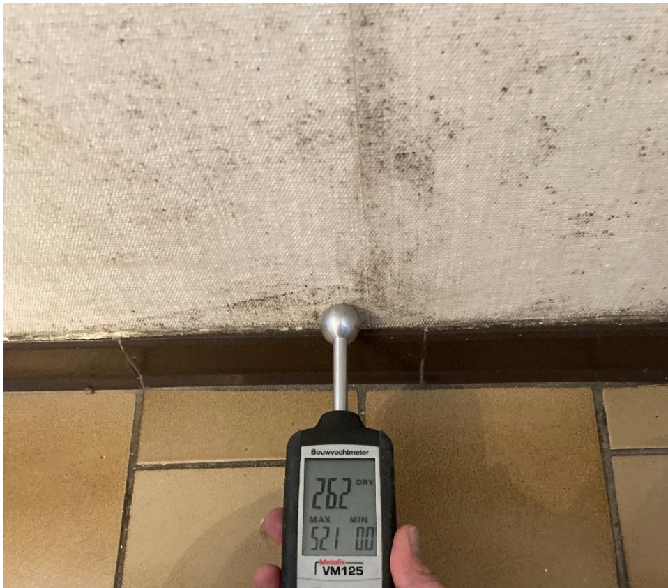
Photo n°6 : séjour rez-de-chaussée, mesure d'humidité absolue de 26,2 sur une échelle de 100,0
