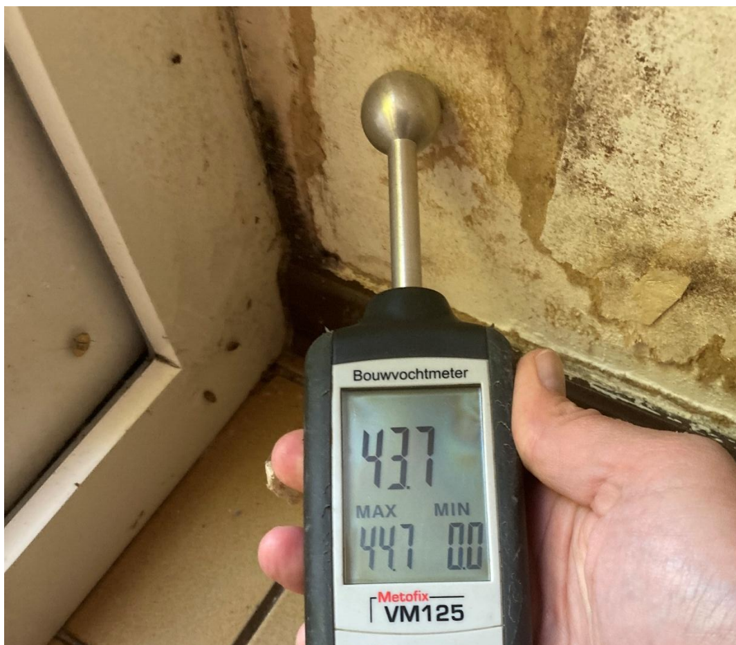
Photo n°10 : rez-de-chaussée, salon sur façade arrière Mesure d'humidité absolue de 43,7 sur une échelle de 100,0
