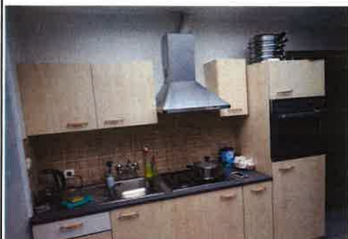
Foto 11: 224: er is onvoldoende verluchting mogelijk in de functie keuken
