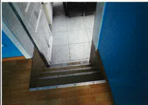
Foto 10: 171: trappen,overlopen,borstweringen met gebruiksonveilige elementen(te steil/gebreken ...) / trap naar een woonfunctie ontbreekt
