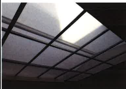
Foto 12: 224: er is onvoldoende verluchting mogelijk in de functie keuken
