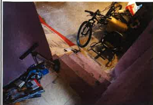
Foto 9: 171: trappen,overlopen,borstweringen met gebruiksonveilige elementen(te steil/gebreken ...) / trap naar een woonfunctie ontbreekt
