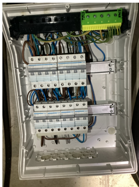
( Elektrisch bord - binnenkant )
